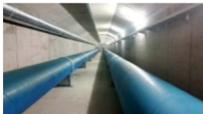
infraestructura de agua
