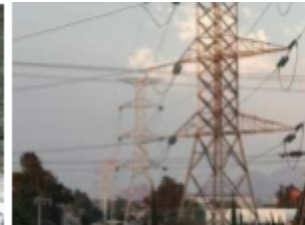
infraestructura de luz
